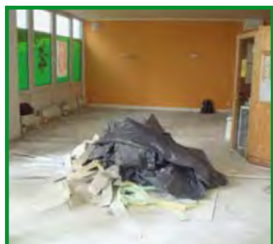
Der Ruheraum während des Umbaus 2010. Leider ließ sich der Plan für eine Fußbodenheizung nicht umsetzen.
